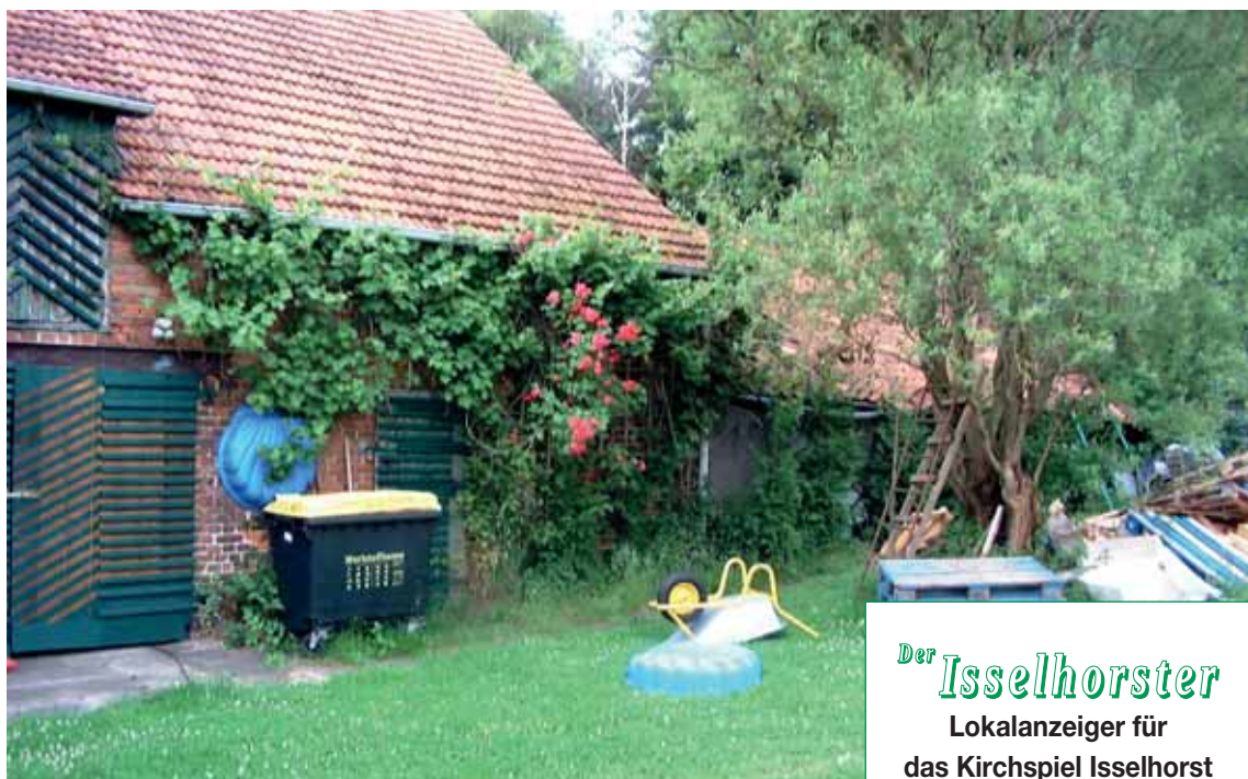
Bild (S. Kornfeld) Der ehemalige Trockenschuppen steht noch (Juni 2017), ist aber sehr baufällig.
